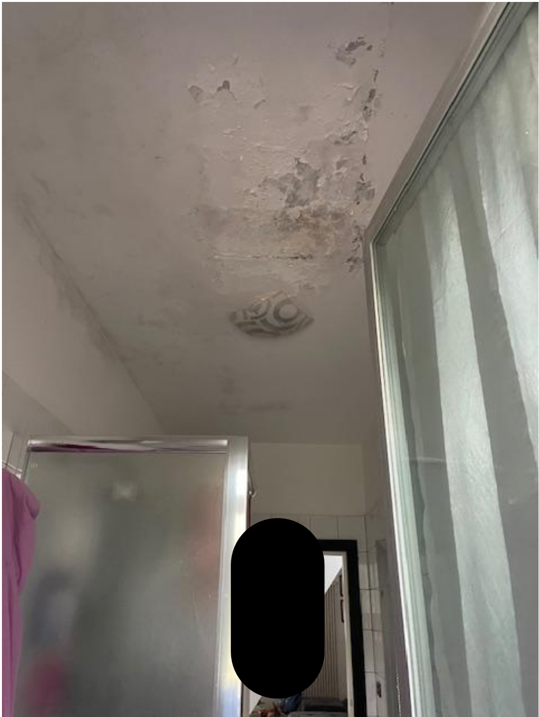
fenomeni di umidità nel bagno zona giorno
