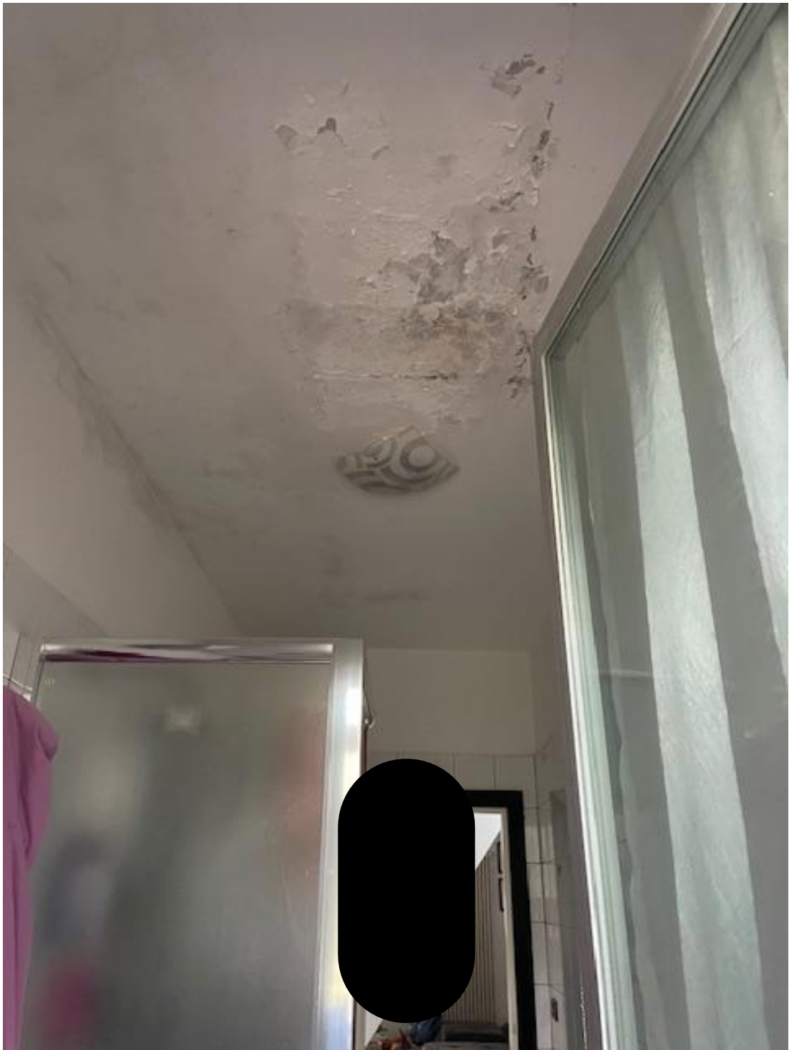
fenomeni di umidità nel bagno zona giorno
